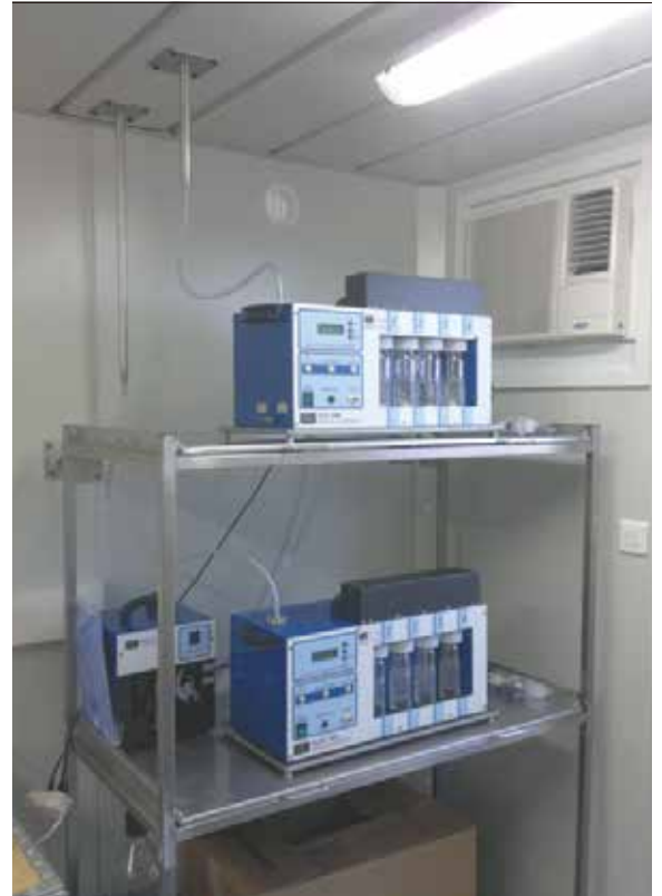
MARC 7000 トリチウムサンプラーと、HAGUE 7000 炭素14サンプラーを空気の吸い込み管と共にステンレス製の架台に設置した写真です。
